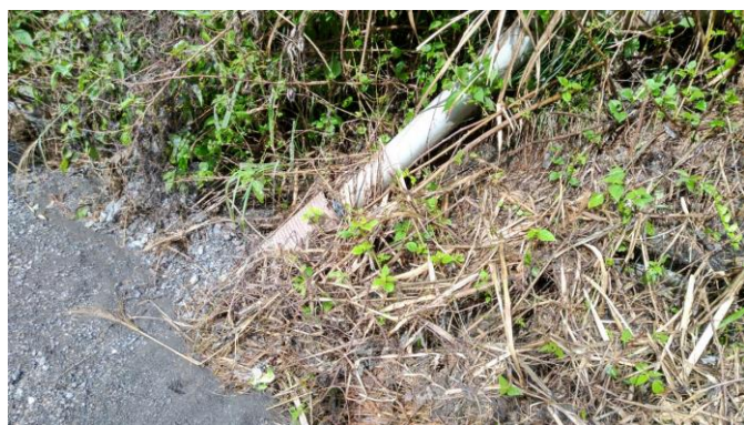
埋もれてしまった浄化槽の排出管
