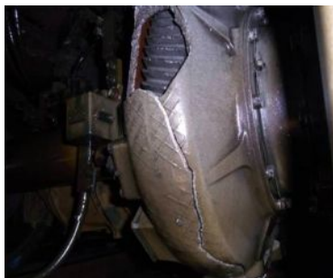
写真は破損した歯車箱。
