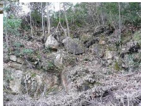
まだまだ危険な箇所
